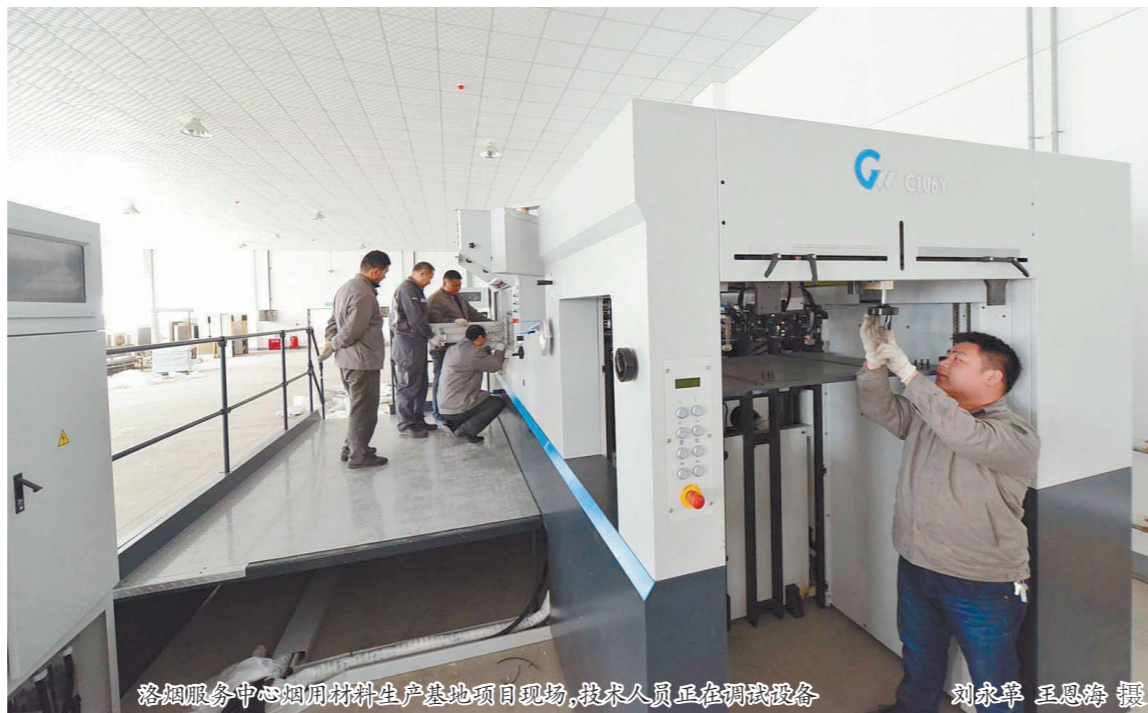
洛阳服务中心烟用材料生产基地项目现场,技术人员正在调试设备 刘永卓 王恩海 摄
